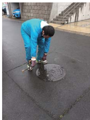
マンホールからの悪臭や側溝の詰まり→高圧洗浄実施 【小林大門下、小林】
