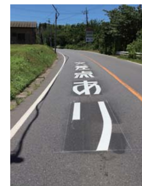
事故防止のための道路標示 【永治、大塚3丁目など】
